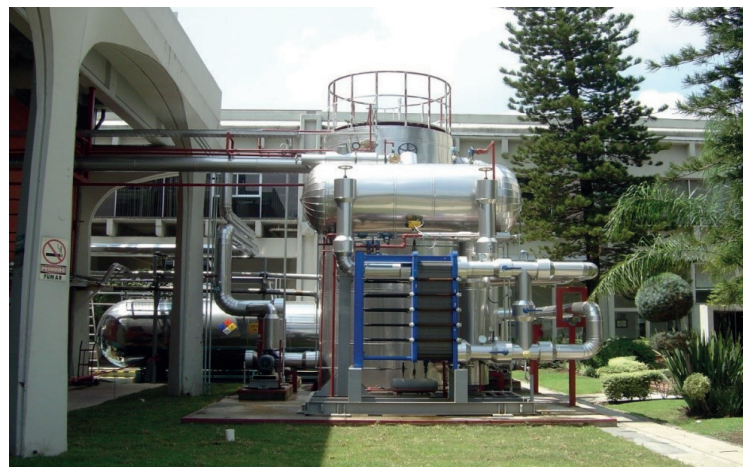
SISTEMA DE REFRIGERACIÓN
